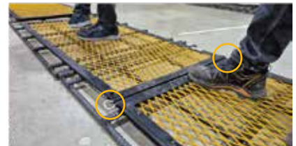
연결고리 체결 후 들뜸 현상 ×
